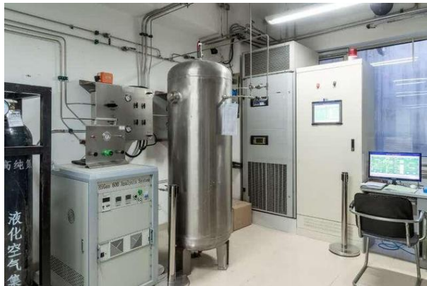
高纯氮气供给系统
